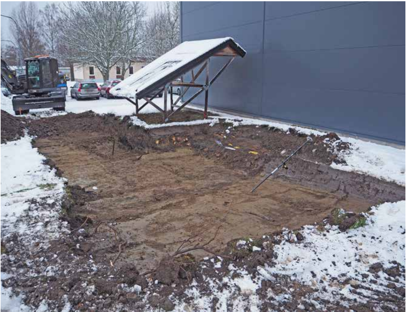
FIGUR 6. Det västra schaktet (208) efter avslutad avbaning. Närmast husväggen syns de gula markeringsbanden för elkabeln och i kanten kring fundamentet till solcellen framträder jordmassor med bl a tegel samt partier med sot och kol. Från ÖSÖ. Foto: Ann Lindkvist.
