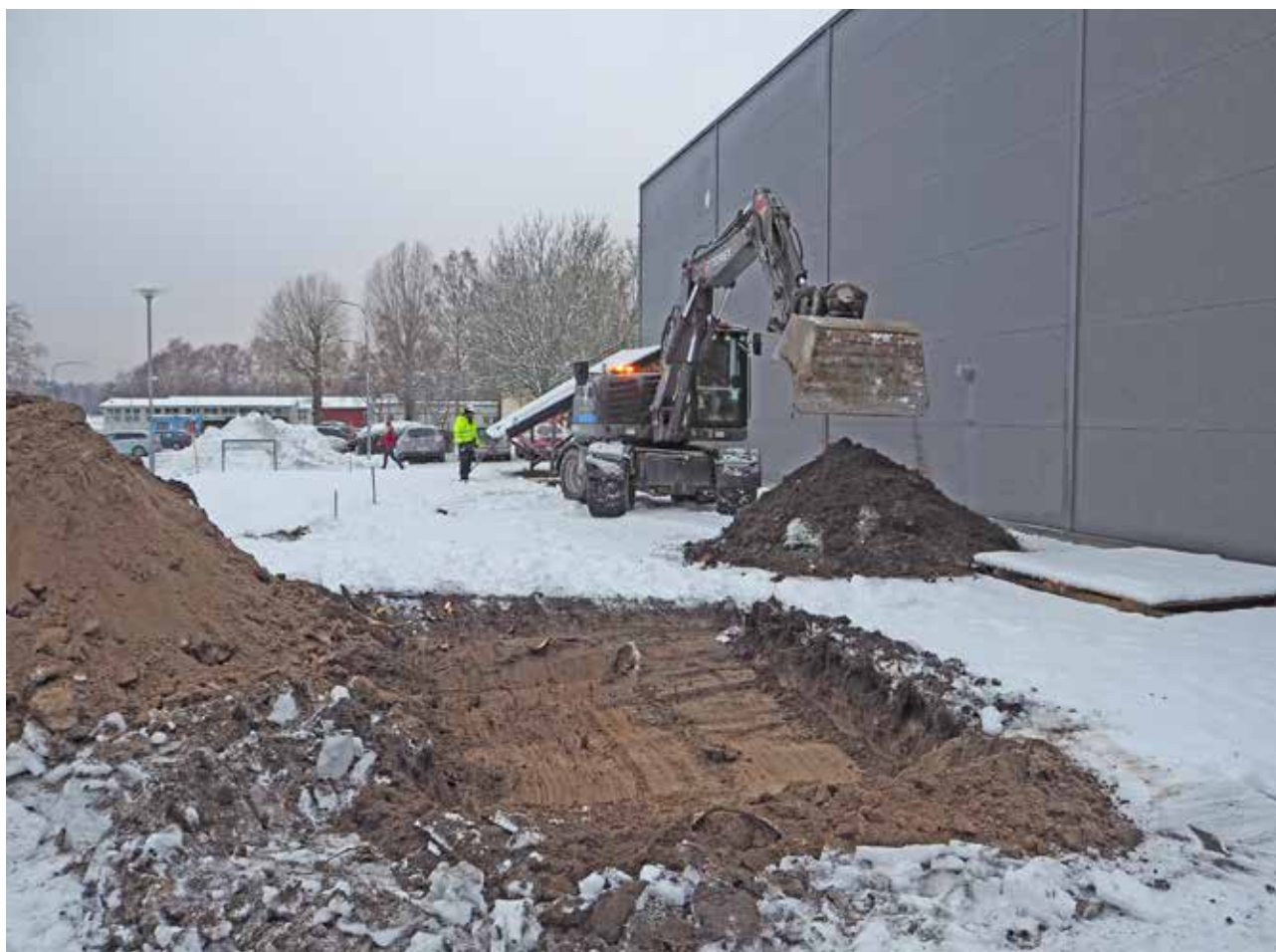
FIGUR 3. Arbetsytan med det östra schaktet (200) i förgrunden. Fredrik Thölin övervakar grävningen av det västra schaktet i bakgrunden. Från ÖSÖ. Foto: Ann Lindkvist.
